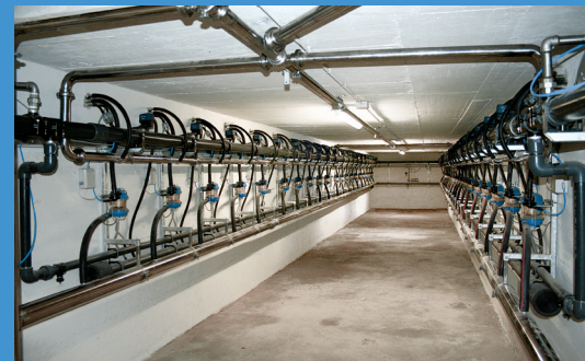
Impiantistica nel tunnel centrale Subway installation
