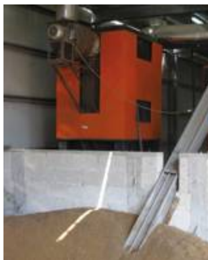
Centrale termica a biomassa da 2 milioni di Kcal, alimentata con nocciolino di oliva.
