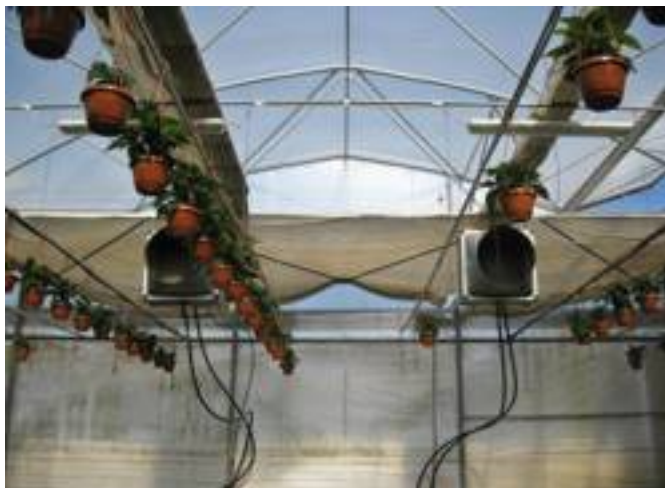
Gli aerotermini per il riscaldamento aereo.
