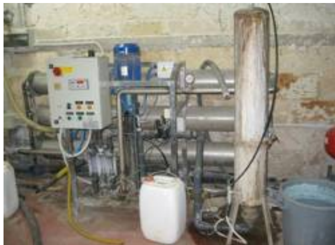
Impianto a osmosi inversa da 5 m 3 /h.
