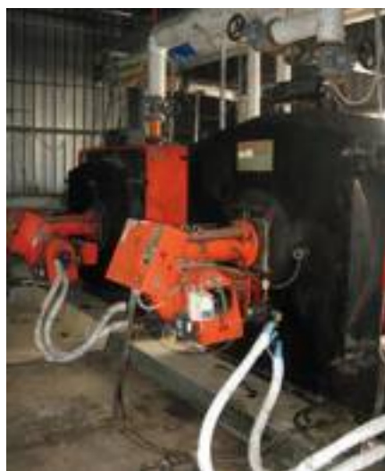
Centrale termica da 4,5 milioni di Kcal alimentata con olio combustibile BTZ (a basso tenore di zolfo).
