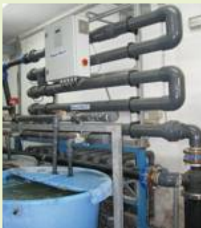
L'impianto Aqua-Hort per la disinfezione dell'acqua.
