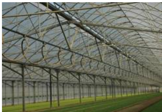
Il tetto è stato costruito secondo lo schema delle capriate, per avere una ridotta spinta laterale.
