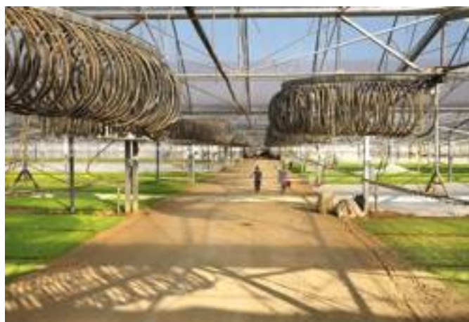
Nella prima parte di strutture troviamo un impianto d'irrigazione a barra mobile con tubo avvolto a spirale, un sistema che ha pregi e anche qualche difetto, come una certa difficoltà di riavvolgimento nelle giornate più fredde.
