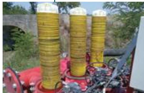
Corpo filtrante di un filtro a dischi. È visibile lo sporco trattenuto dai dischi in plastica.
