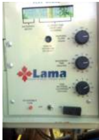
Centralina di controllo del controlavaggio di un filtro automatico.
