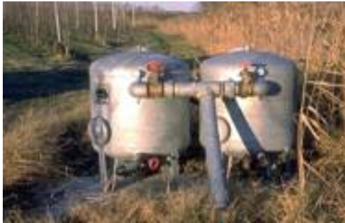
Filtri a sabbia. Stazione costituita da due serbatoi.
