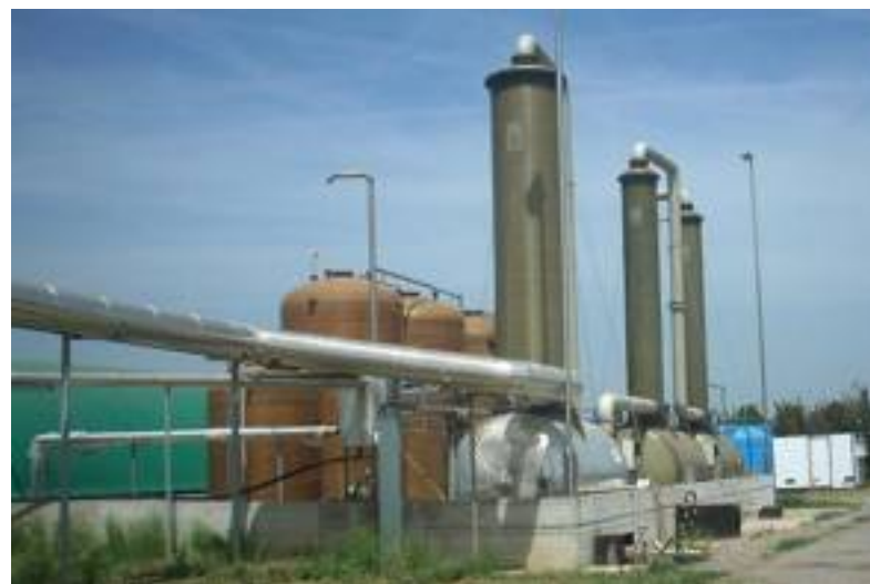
● Un impianto di strippaggio.
