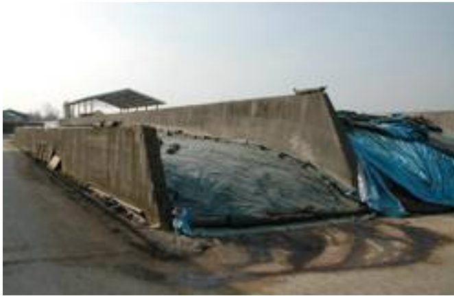
● Trincee molto strette, con difficoltà di calpestamento dell'insilato e, dunque, rischi di cattiva conservazione.
