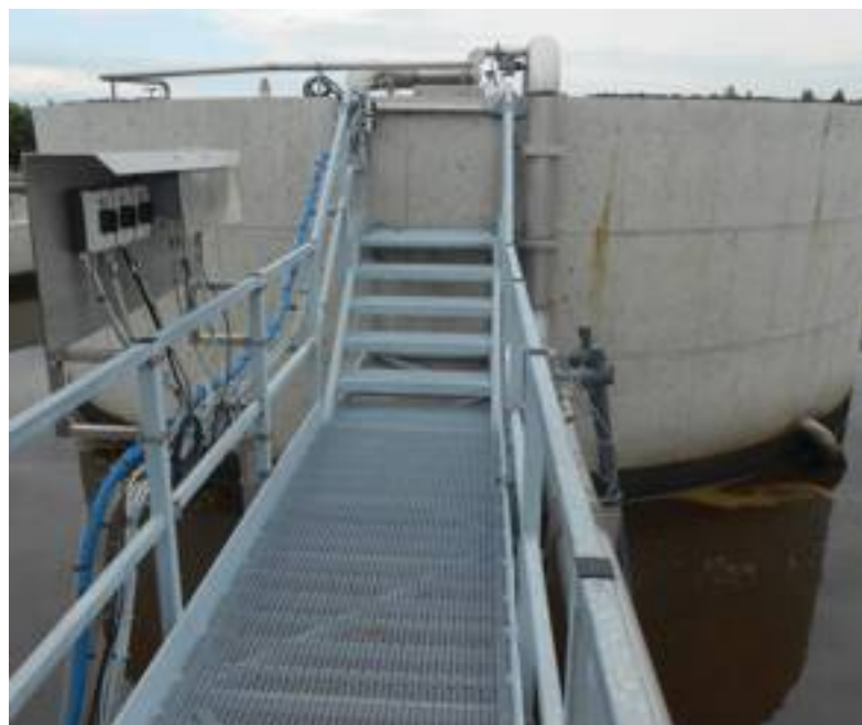
La vasca interna, deputata alla nitrificazione della biomassa. E attorno a essa la vasca esterna, per la denitrificazione.
