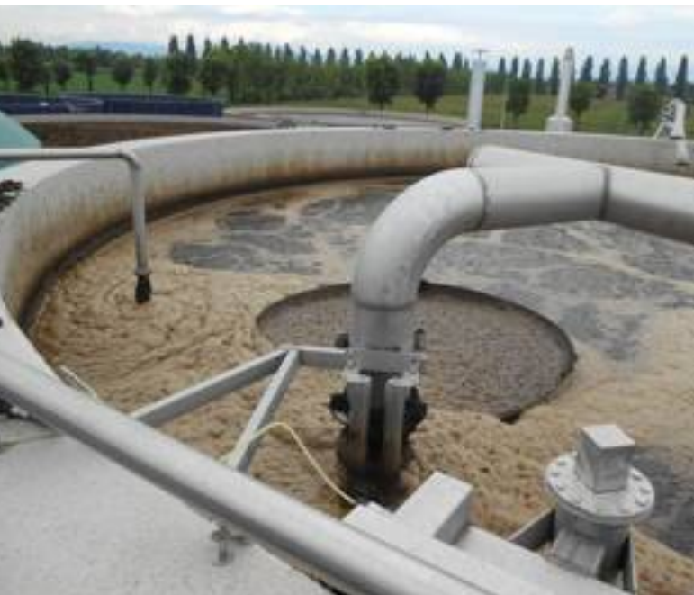
Il trattamento del liquame contenuto nella vasca interna. Qui avviene la nitrificazione: l'azoto ammoniacale tramite ossidazione biologica diventa nitrato.
