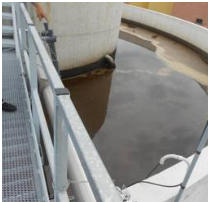
La vasca esterna, dove avviene la denitrificazione.
